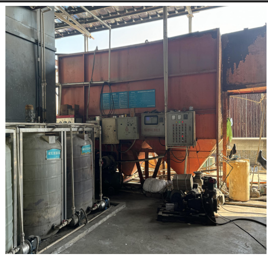
废水治理设施
