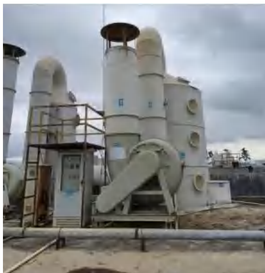
废气处理设施
